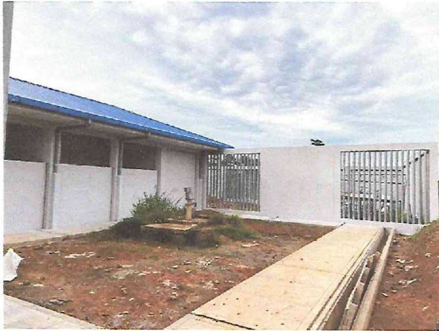
FOTO N°09: Vista del pintado interior del cerco perimétrico y exteriores de aulas en la obra "Mejoramiento y Equipamiento del servicio Educativo N° 62200 Barrio Carabanchel - San Lorenzo, Distrito Barranca, Provincia Datem Del Marañón - Loreto".
