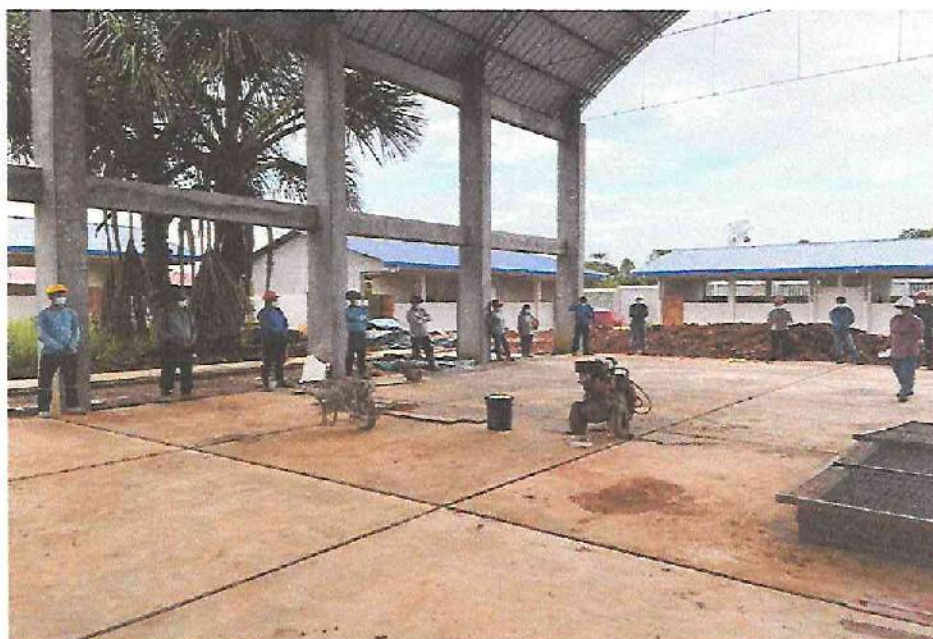
FOTO N°01: Vista de la charla de seguridad en la obra "Mejoramiento y Equipamiento del servicio Educativo N° 62200 Barrio Carabanchel - San Lorenzo, Distrito Barranca, Provincia Datem Del Marañón - Loreto".
