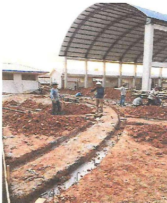
FOTO N°12: Vista vaciado de solado de las cunetas en la zona recreacional para los niños en la obra "Mejoramiento y Equipamiento del servicio Educativo N° 62200 Barrio Carabanchel - San Lorenzo, Distrito Barranca, Provincia Datem Del Marañón - Loreto".
