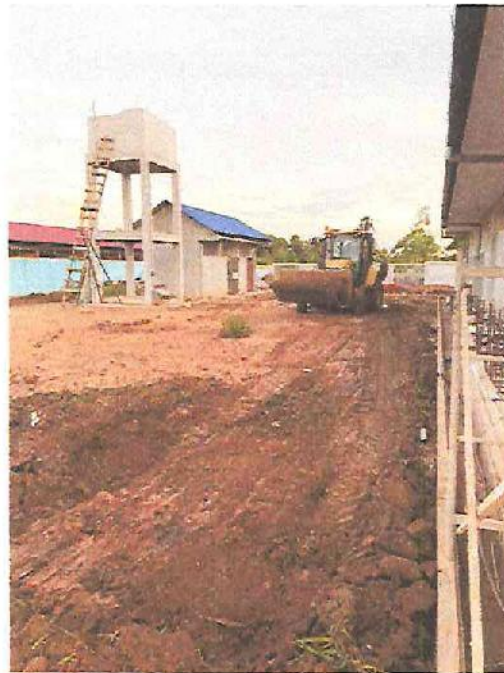
FOTO N°05: Vista de maquinaria retroexcavadora realizando limpieza de terreno en la obra "Mejoramiento y Equipamiento del servicio Educativo N° 62200 Barrio Carabanchel - San Lorenzo, Distrito Barranca, Provincia Datem Del Marañón - Loreto".
