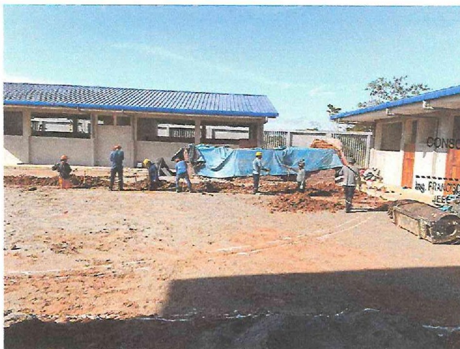
FOTO N°02: Vista del trazo y excavación de zanja para la instalación de tubería exterior de desagüe de la obra "Mejoramiento y Equipamiento del servicio Educativo N° 62200 Barrio Carabanchel - San Lorenzo, Distrito Barranca, Provincia Datem Del Marañón - Loreto".
