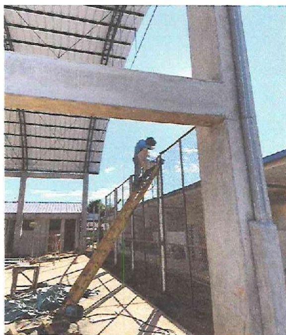
FOTO N°16: Vista de soldadura de las rejas en el perímetro del polideportivo en la obra "Mejoramiento y Equipamiento del servicio Educativo N° 62200 Barrio Carabanchel - San Lorenzo, Distrito Barranca, Provincia Datem Del Marañón - Loreto".
